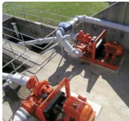
Стационарные насосы с электроприводом Dri-Prime, подающие стоки после фильтрации на стадию хлорирования перед сбросом.
